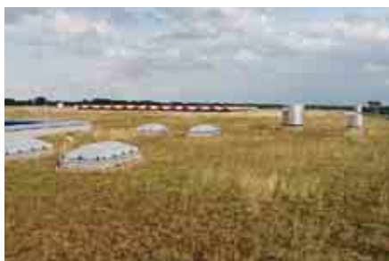
El sistema convencional de cubierta verde extensiva (de tipo "Sedum tapizante") evapora 20–50 litros al día durante el verano.
