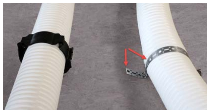
Tubo demasiado apretado con cinta de metal perforada.
