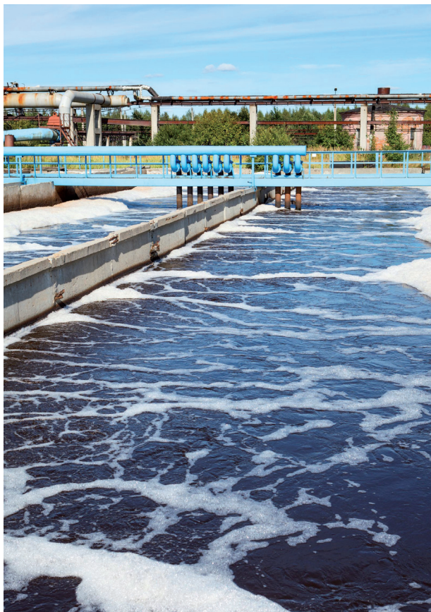
Tratamiento de aguas: EDAR
