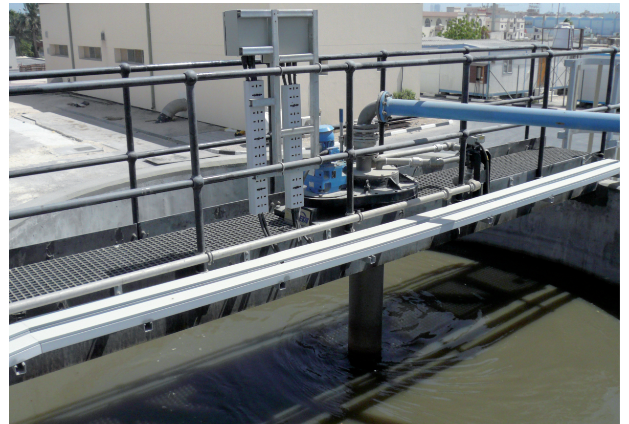
Tratamiento de aguas: EDAR
