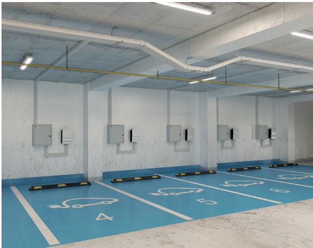
Instalaciones de recarga de vehículos eléctricos
