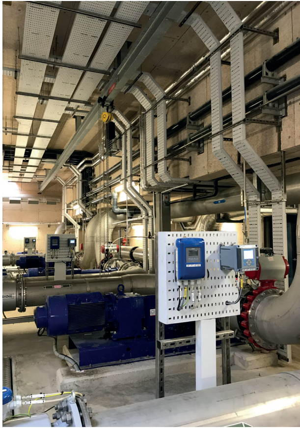
Tratamiento de aguas: EDAR
