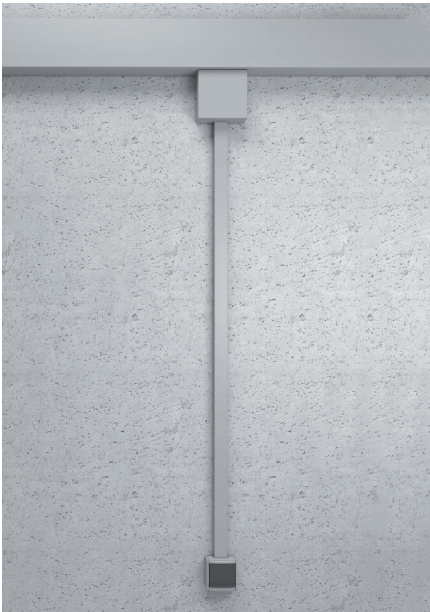
Nave industrial: alimentación de mecanismos
