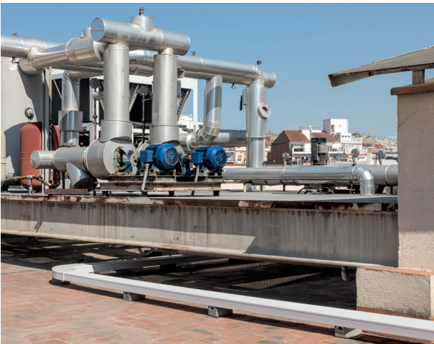
Instalaciones en azoteas
