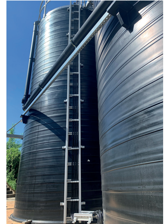
Tratamiento de aguas: EDAR
