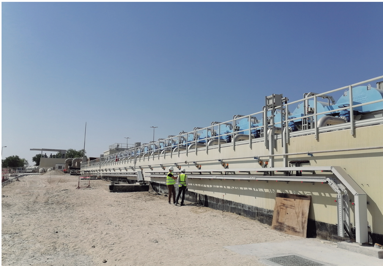
Tratamiento de aguas: EDAR
