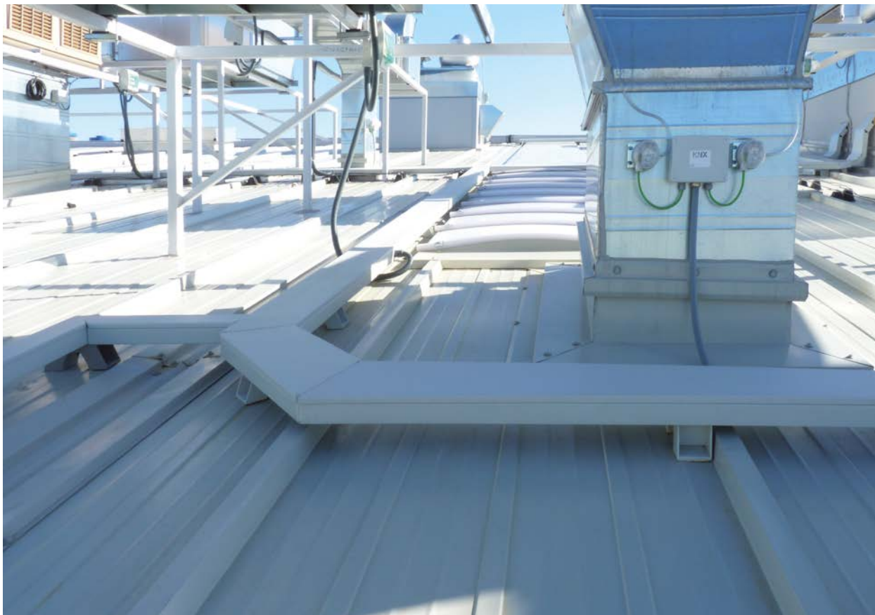
Energía fotovoltaica: depósito de autobuses
