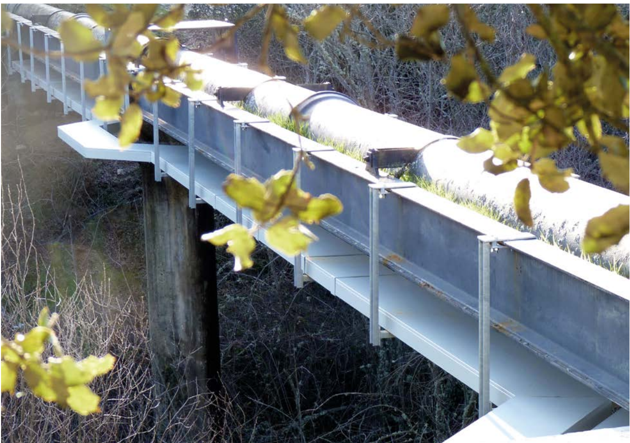
Producción y distribución de energía eléctrica
