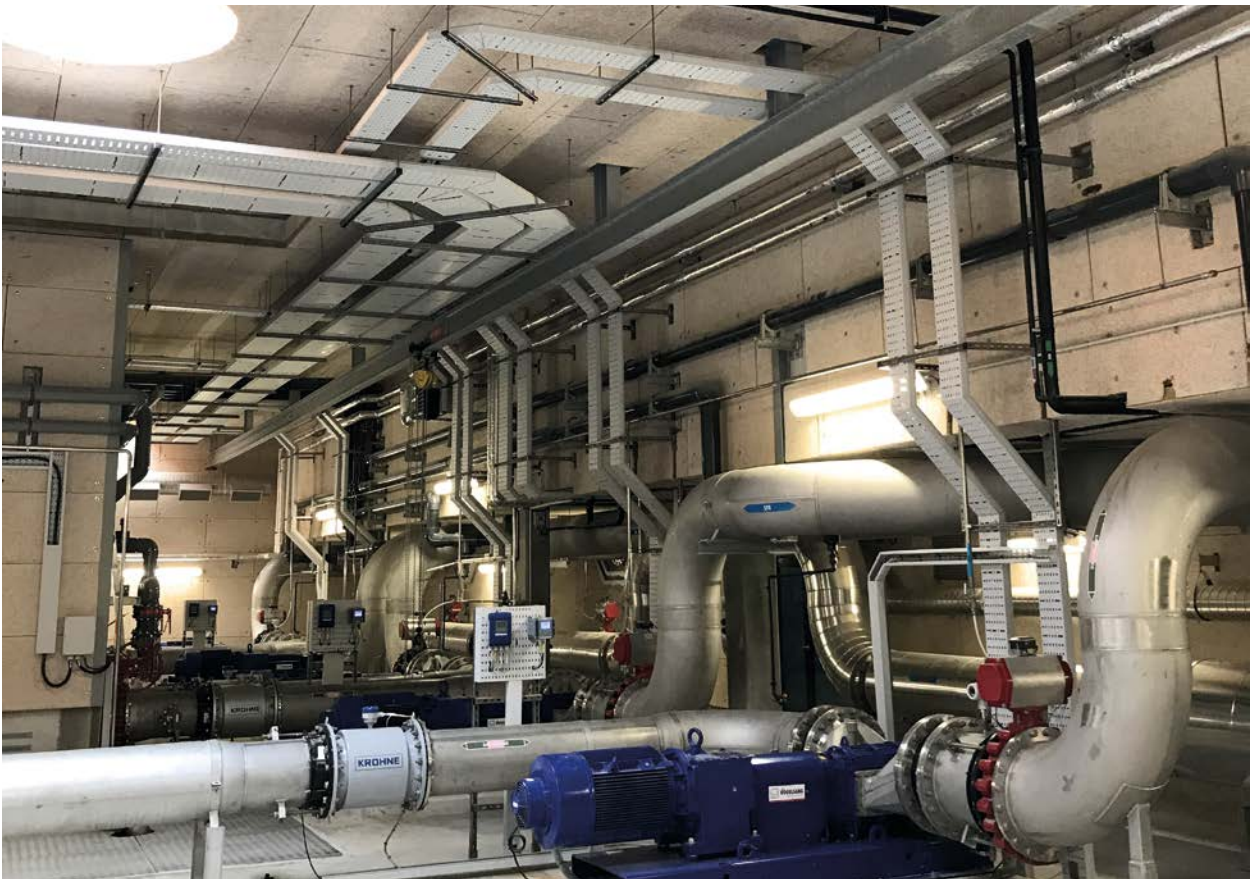
Tratamiento de aguas: EDAR
