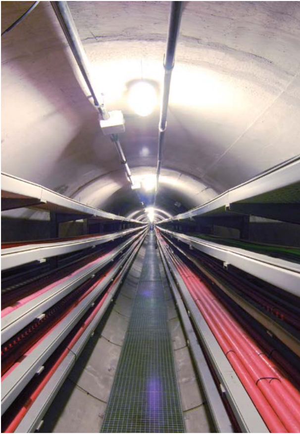
Aeropuerto: galería técnica
