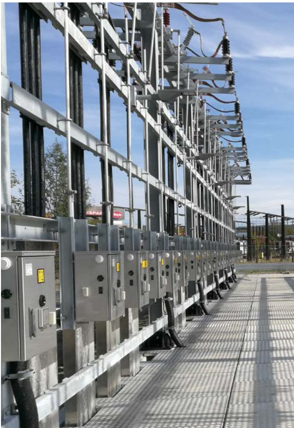
Producción y distribución de energía eléctrica
