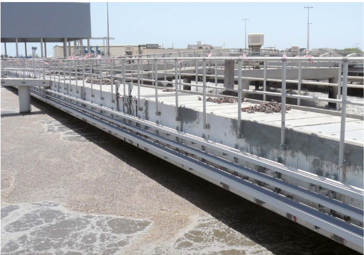
Tratamiento de aguas: EDAR
