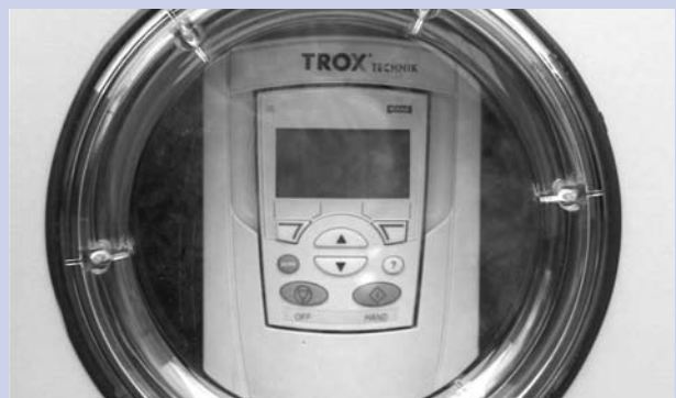
Convertidor de frecuencia
