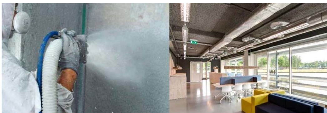
Figura 6: Aislamiento de celulosa proyectada (a la izquierda el proceso de instalación – a la derecha el producto instalado)
