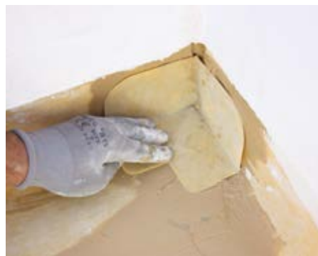
8. Utilizar los diferentes complementos DRY80 CORNERIN , CONEROUT y SUMI56 para resolver los puntos singulares.
