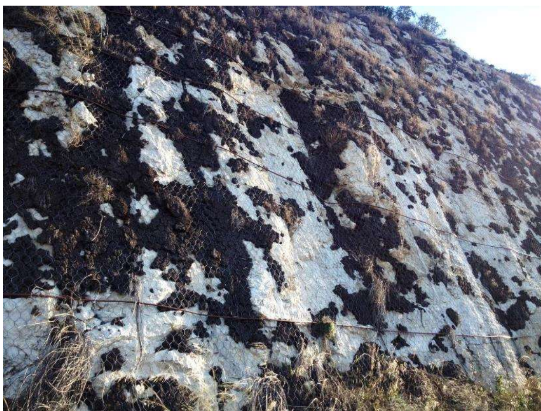
Figura 11_Detalle de sistemas sin estructura interna del sustrato. El sustrato se disgrega y es arrastrado con el tiempo.
