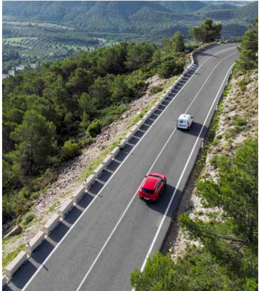
Muro de barrera ven el Puerto de la Carrasqueta, Alicante (Comunidad Valenciana).
