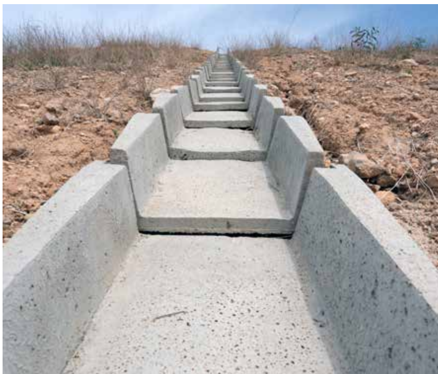
Sistema de recogida de pluviales en accesos aeropuerto de El Altet, Alicante (Comunidad Valenciana).
