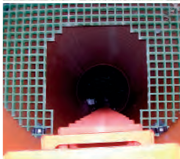
TRAMEX DE POLIÉSTER EN POZOS SANECOR®.
