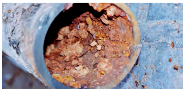
TUBERÍA DE SANEAMIENTO CON DEPOSICIONES DE MATERIAL.
