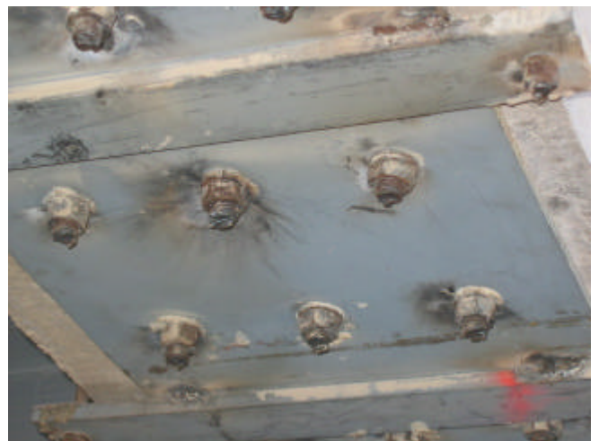
Fotografías núm. 12 y 13. Anclaje de las pletinas.
