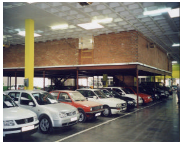
Foto 4.- Vista de las sobrecargas fruto de un cambio de uso: construcción de almacén en estructura metálica y mampostería para recambios de automóvil.
