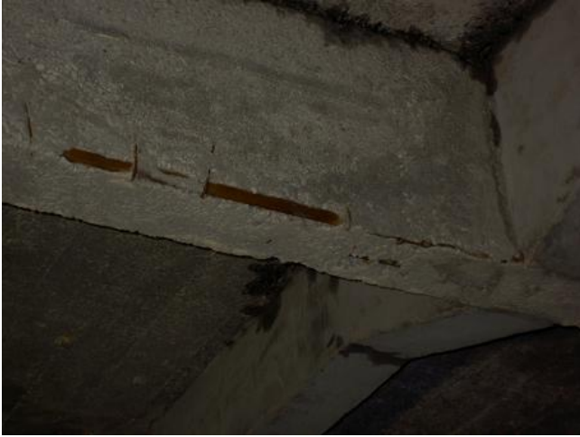
Recubrimiento de hormigón deficiente. Estado inicial de la estructura.
