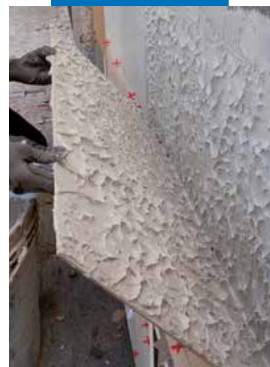
Comprobación de la completa impregnación del reverso de la baldosa en colocación en fachada exterior
