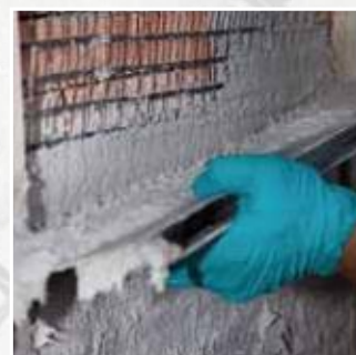
Aplicación del sistema Planitop HDM Restauro y Mapegrid G220 sobre una pared de albañilería
