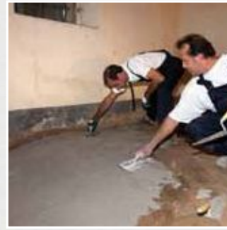
Aplicación a llana de la primera capa de Planitop HDM Restauro en el trasdós de una bóveda
