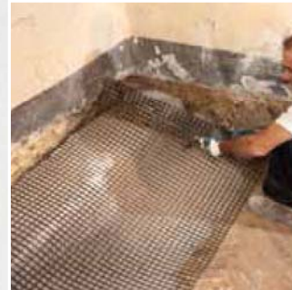
Posicionamiento de la malla de refuerzo de fibra de vidrio álcali-resistente Mapegrid G220
