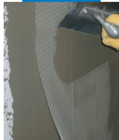
Enlucido de paneles termoaislantes armado con Malla de Fibra de Vidrio embebida en la capa de Mapetherm AR1
