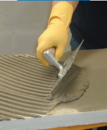
Aplicación de Mapetherm AR1 sobre el reverso del panel, con llana dentada
