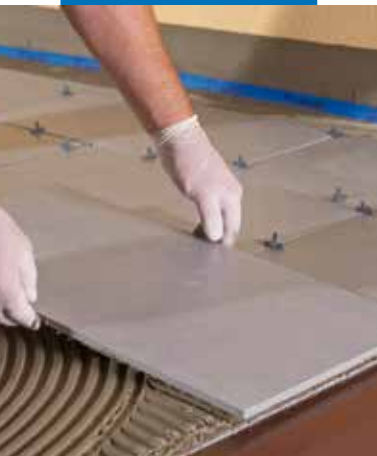
Colocación del gres porcelánico sobre pavimentación ya existente con Keraflex Extra S1
