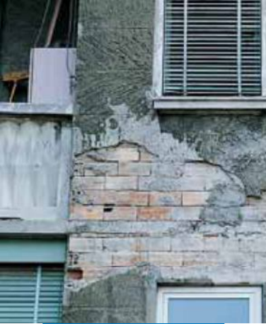
Edificio degradado que precisa de una reparación
