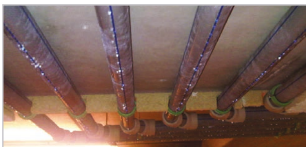
Condensación en tuberías de agua fría
