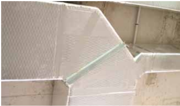
LA INSTALACIÓN DE CONDUCTOS CLIMAVER PERMITE REDUCIR LAS PÉRDIDAS EN UN 70% RESPECTO A UN CONDUCTO DE CHAPA SIN AISLAR.
