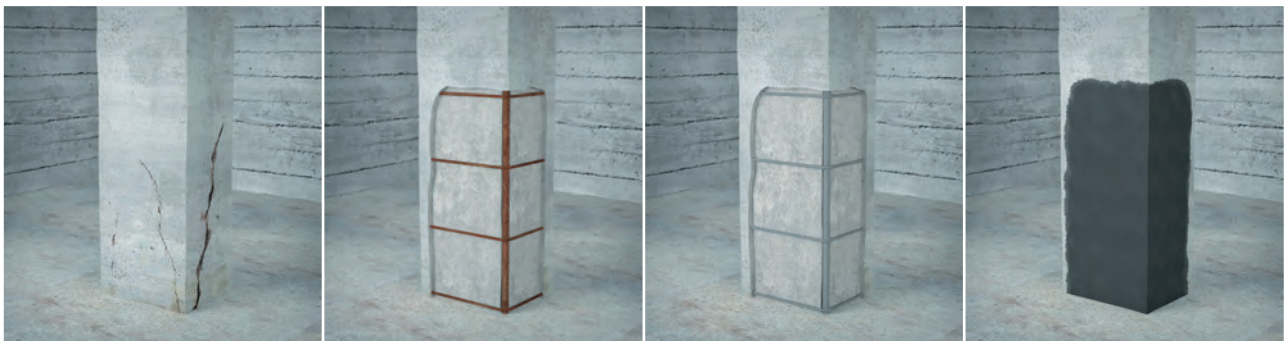
Paso 1: Detección de la patología.
