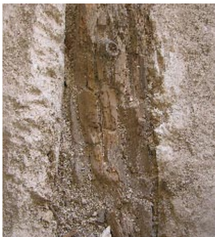
Ataque por hongos de pudrición parda.
