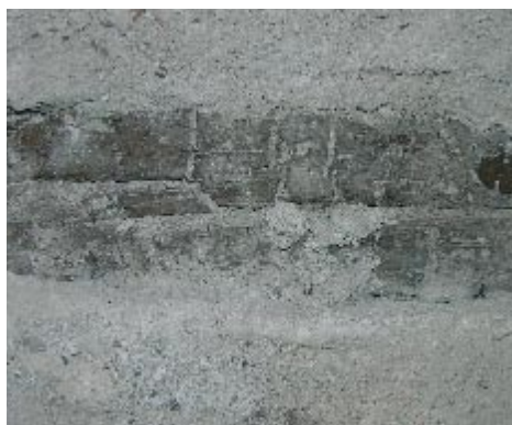
Vigueta con ataque por hongos de pudrición.
