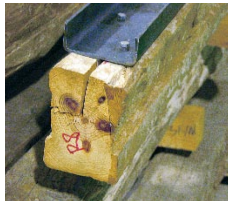
Refuerzo de acero de una pletina inferior sobre la madera.
