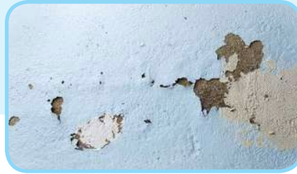
Daños de las sales: Desconchados de pintura
