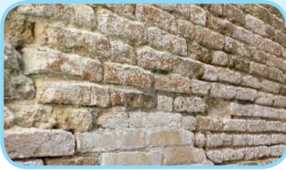
Daños de las sales: Desmoronamiento de ladrillos
