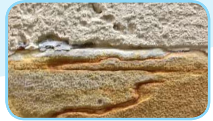
Daños de las sales: Desintegración de arenisca
