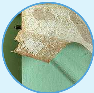
Deterioro del papel pintado
