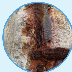
Pérdida hormigón y oxidación de las armaduras
