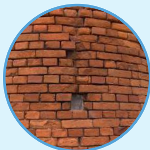
Pérdida de ladrillos
