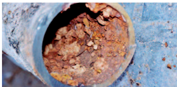
TUBERÍA DE SANEAMIENTO CON DEPOSICIONES DE MATERIAL.
