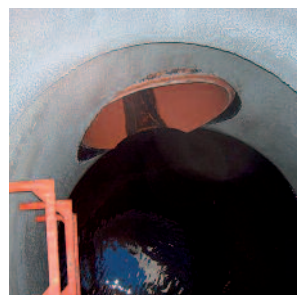
FALTA DE ESTANQUEIDAD EN POZOS DE HORMIGÓN.
